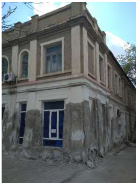
Рис. 1. Характер разрушения здания по ул. А.Шамуратовой г. Нукуса (2018 г)
